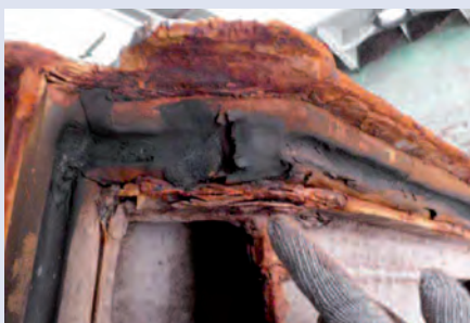
舱盖板密封橡皮损坏且其有超过制造商建议值的永久变形现象。密封橡皮槽严重腐蚀。
