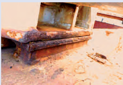
舱盖板支撑垫板腐蚀耗损。
