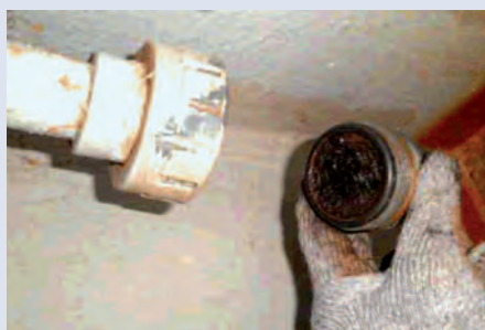
舱口围缘排水管塞满了残骸碎片和锈渣。
