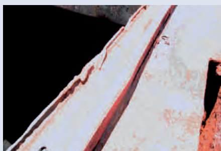
紧压杆和内侧排水槽有机械性损伤。
