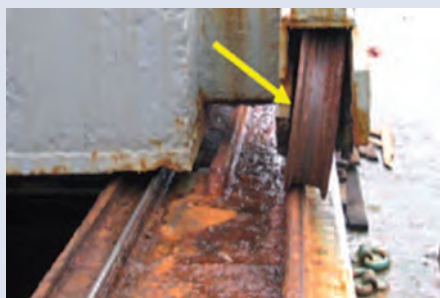
舱盖板导槽轮子轴承故障 - 舱盖板关闭时无法平整。
