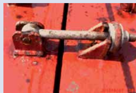
Trinca transversal de tapa cambiada pero aún con la goma envejecida.
