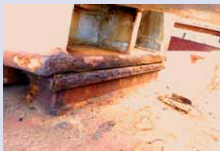
Piezas de tope de las tapas corroídas y deformadas.
