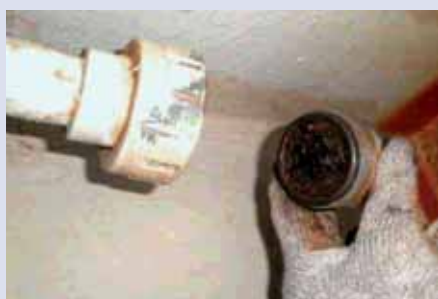
Tubo de achique de brazola completamente bloqueado con restos y roña.
