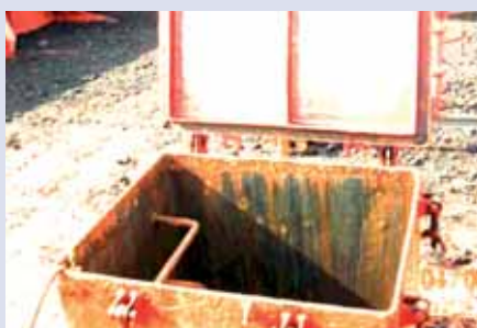
Evidencia de entrada de agua por la escotilla de paso de hombre a bodega.
