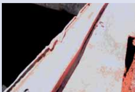
Daño mecánico en la barra de compresión y en el canal de achique interior.
