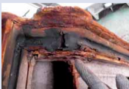
Frisas de goma de las tapas dañadas mostrando deformación permanente fuera de límites tolerables. Canaletas de frisas muy corroídas.
