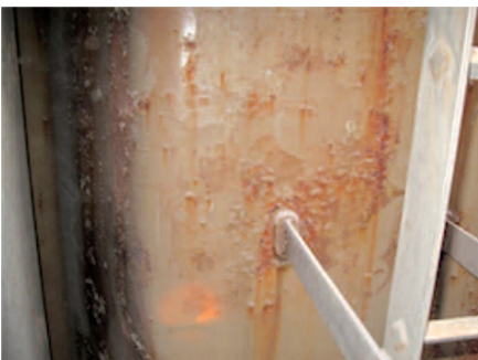
液货舱涂层劣化
