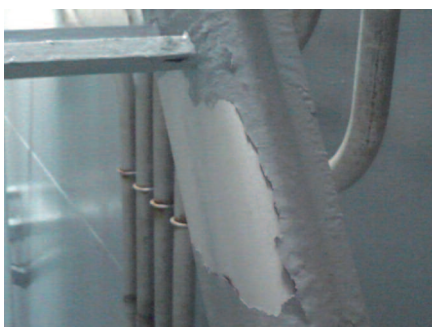
液貨艙塗層因過熱受損
