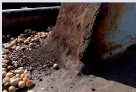
ハッチコーミングが清掃されておらず貨物の破片や錆が明らかに見られる。センターラインジョイント閉鎖ウエッジの著しい摩耗が見られる。
