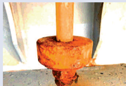
固着し、ペンキが塗られたハッチ固定クリート
