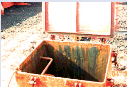
貨物輸入口ハッチとハッチコーミングにおける侵水跡
