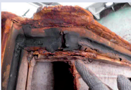
ハッチカバーシールゴムが損傷しており、推奨される限界を超える永久へこみが見られる。ゴムシール溝が著しく腐食している。
