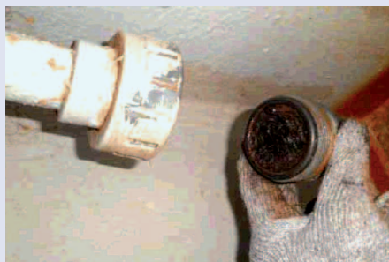
ハッチコーミングのドレンが、残り屑や錆により完全に塞がれている。
