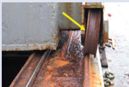
ハッチカバーガイドホイールのベアリングが壊れており、ハッチカバーが均等に閉まらない。
