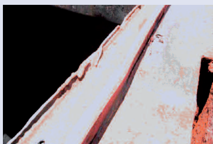
コンプレッションバーとインナードレン溝の機械的損傷
