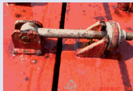
クロスジョイントクリートが新替されているが、古い劣化したゴムをまだ使用している。
