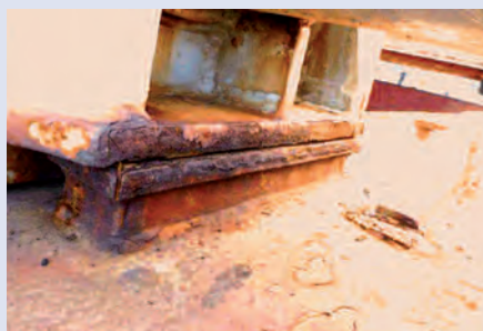
艙蓋板支撐墊板腐蝕耗損。
