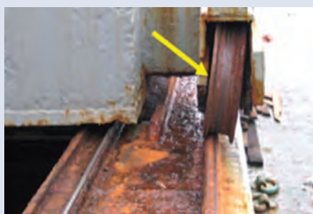
艙蓋板導槽輪子軸承故障——艙蓋板關閉時無法平整。
