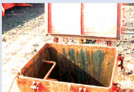
貨艙出入口和艙口圍緣有明顯的進水痕跡。
