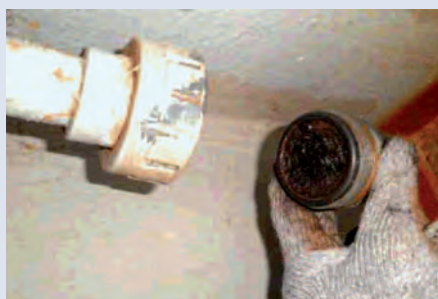
艙口圍緣排水管塞滿了殘骸碎片和銹渣。
