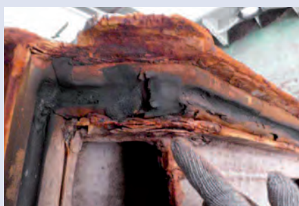
艙蓋板密封橡皮損壞且其有超過製造商建議值的永久變形現象。密封橡皮槽嚴重腐蝕。
