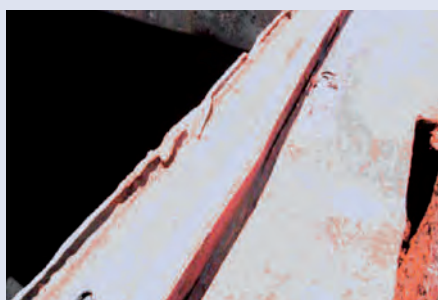
緊壓杆和內側排水槽有機械性損傷。
