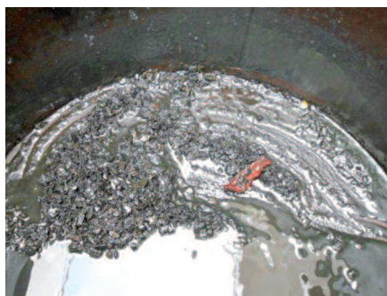
タンク底部のワックス質沈殿物／スラッジ
