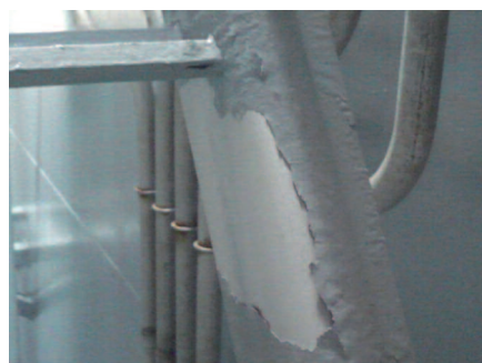
過度の熱のために損傷したタンクのコーティング
