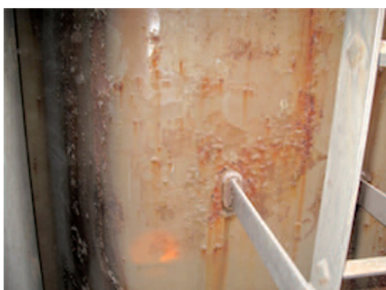
タンクコーティングの劣化
