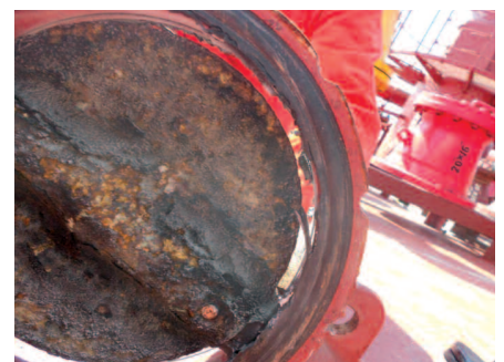
損傷したドロップバルブ
