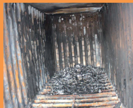
コンテナ後部から撮った写真、合板床の多くが焼けて鋼製の支持梁がむき出しになっているのが見える。
