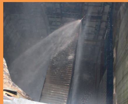
把消防水管固定住以持续喷水让装有煤炭的「祸首」货柜内部以及边界降温。
